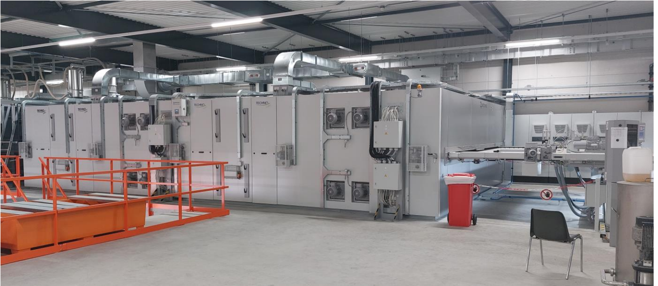
Foto: elektrisch beheizter BRÜCKNER DUO-THERM Teppichtrockner bei INTERCARPET
